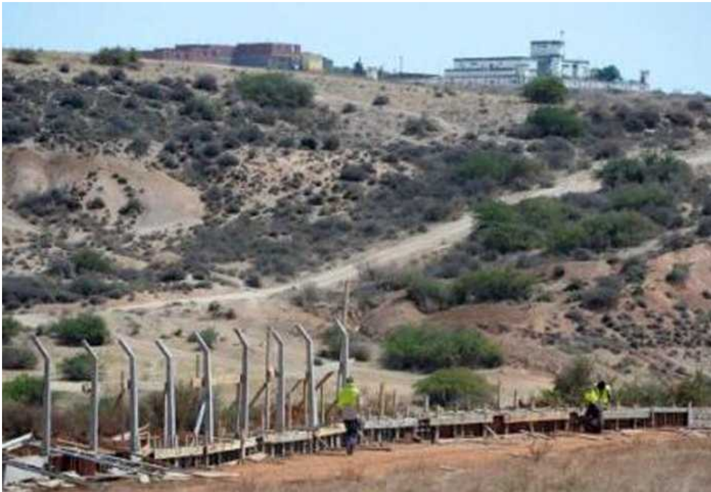
Des ouvriers marocains construisent une clôture face au poste frontière algérien, près de la ville marocaine d'OUJDA, en 2014.
